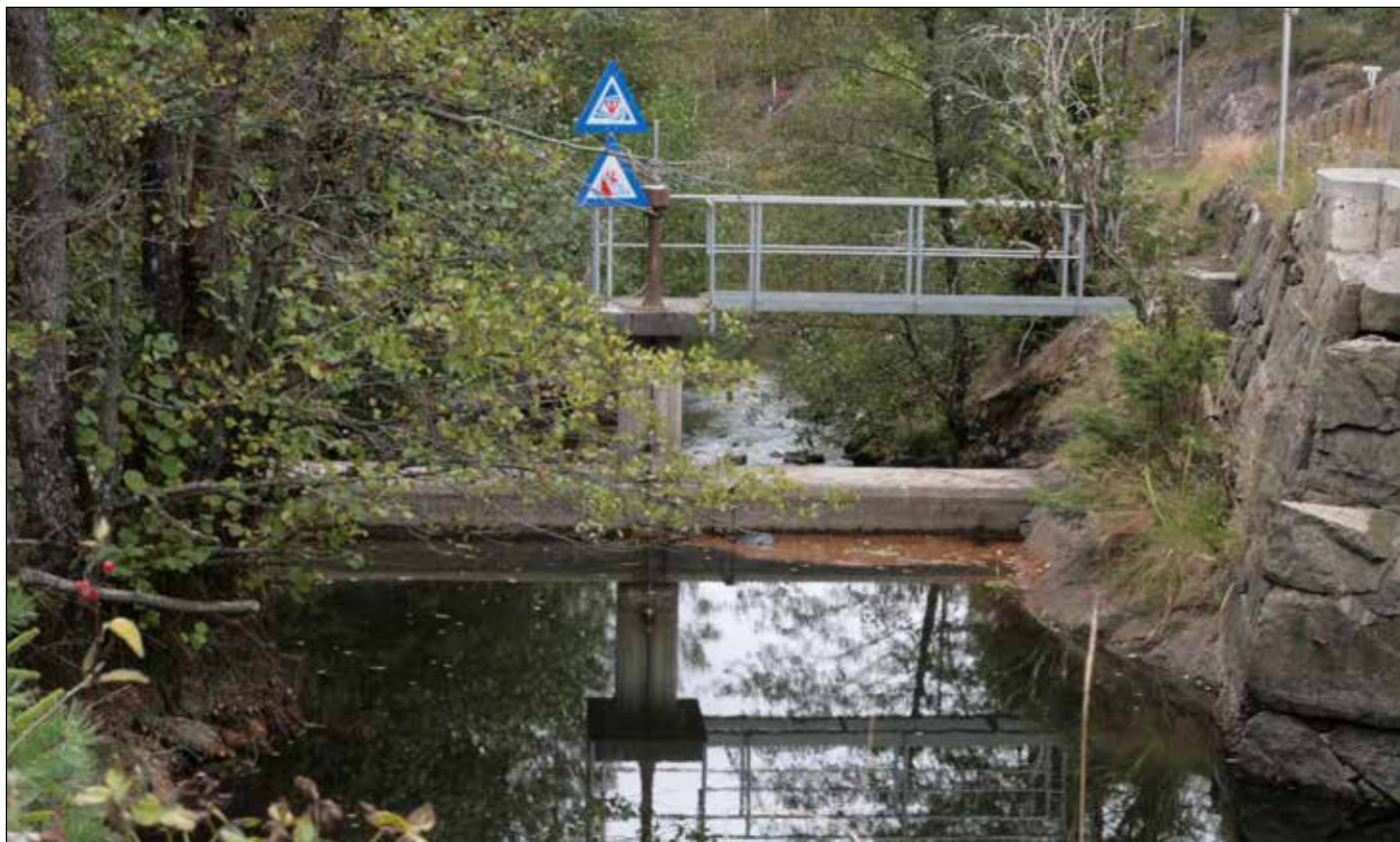
Overløp og reguleringsluke styrer vannmengden både i elva og i Gjersjøen. Foto: TDA
