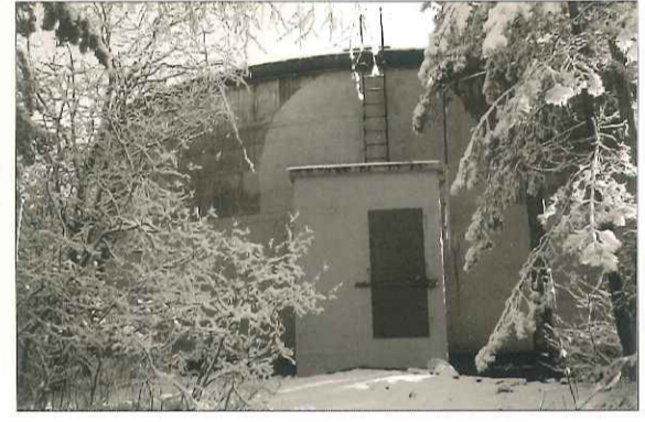
Vannforsyningsystemet i Oppegård har behov for en utvidelse av det tilgjengelige bassengvolumet. Dette skjer med basis i det eksisterende høydebassenget på Hellerasten. (Foto utlånt fra Oppegård kommune).
