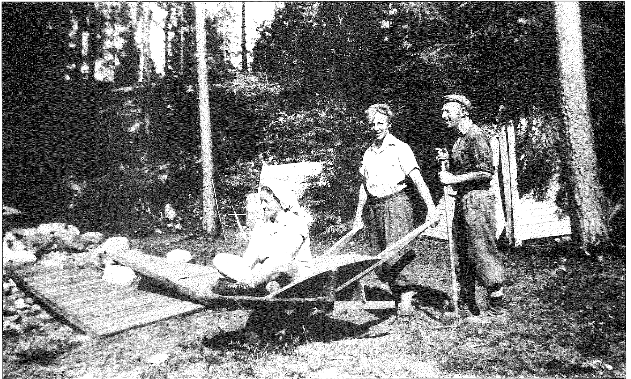
Øverst - Hjørdis, Frank og Birger Arnesen i 1949 da de bygget «Arneli» på Sofiemyr (Hermods vei 6).
