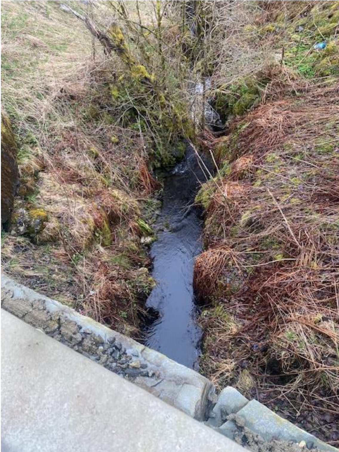
Strekning med sammenrast mur nedenfor gamlevegen v/ pumpehus
