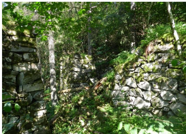
Figur HS13: Holte sag sett sørfra med flere gran- og løvtrær som vokser tett på søylen og støttemuren som har delvis rast ut.
