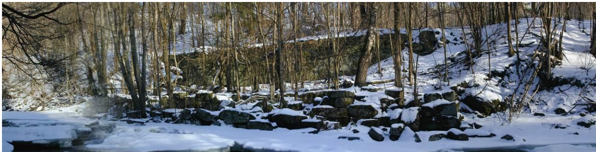
Figur UM8: Mølla sett fra Bærumsiden: Merk den 30. meter lange støttemuren lengst vekk fra Lysakerelva. Muren har begynt å sige fremover øverst mot nord (til venstre i bildet).
