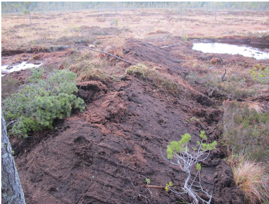
Figur 15: Eksempel på «demning» etter tetting av grøft. Selve grøfta kan fylles av annet hogstavfall eller avfall fra slåttene i overkant og nedkant av demningen, men selve demningen skal fylles med torv. Foto: Pål Martin Eid.
