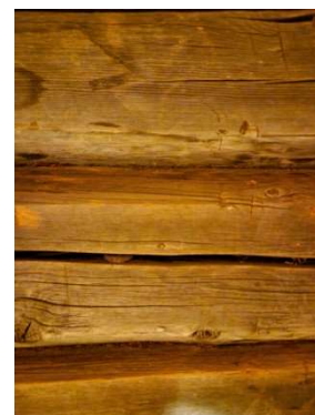
- og litt gammel yttervegg.
