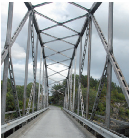
Det er tre viktige bruer i Jøssund. Brua over Jøs-sundstrømmen, bygd i 1939 var et praktbygg, med tilfredsstillende ikke dagens krav. Foto: Helge Bueng
