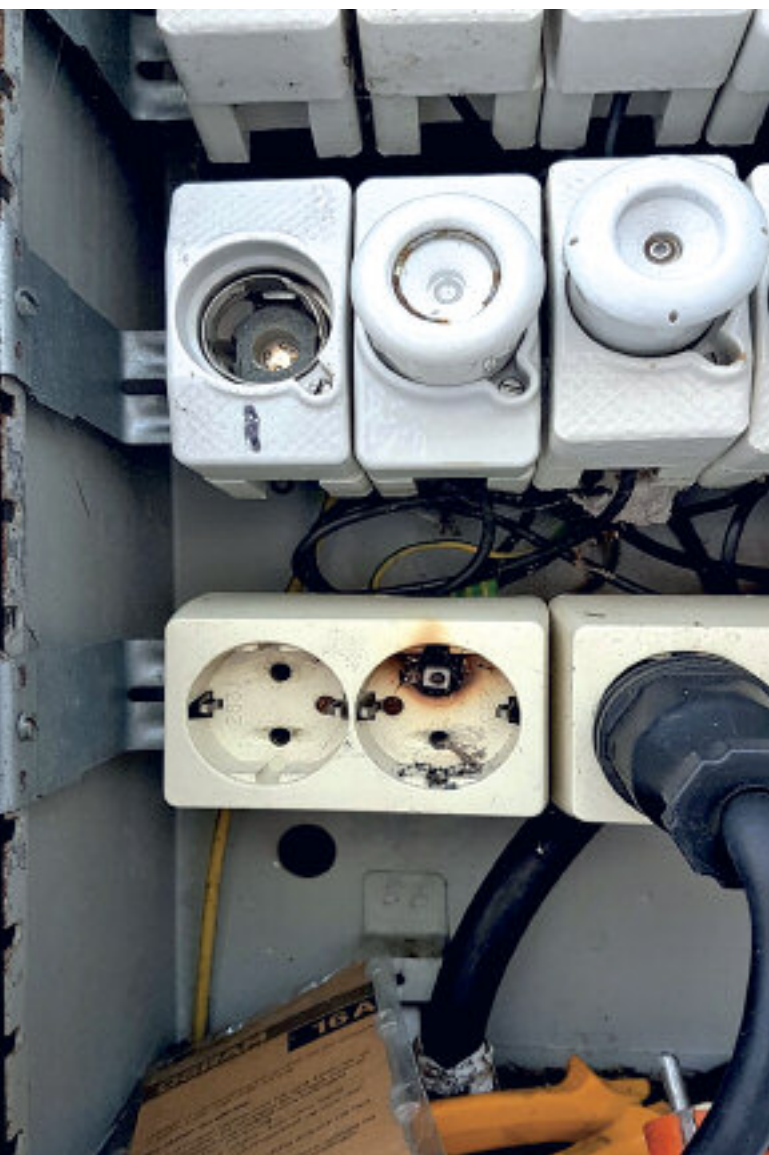
Dette bildet viser varmgang i en tilkobling på en campingplass.
