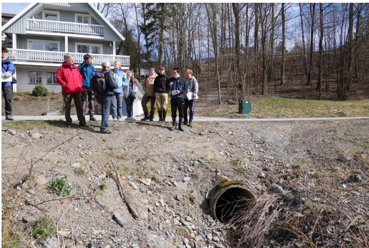
Tjersrudbekken i Bærum ble lukket for mange år siden. I år tar Bærum kommune mål av seg til å åpne bekken ned til Skallumdammen. Foto Bo Wingård
