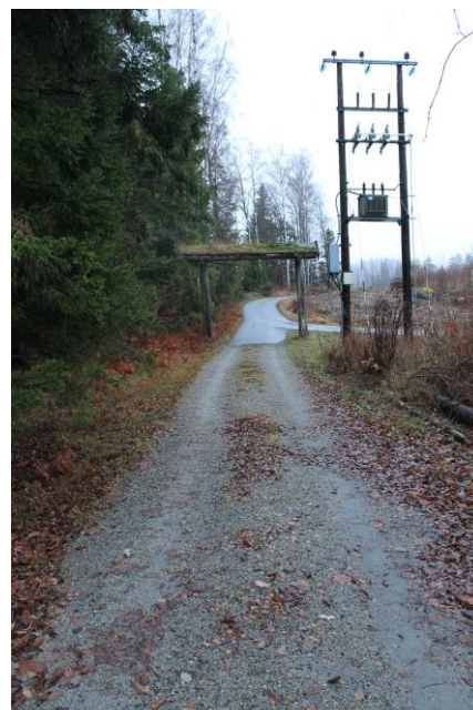
Trafo i mast ved KFUM/KFUK
