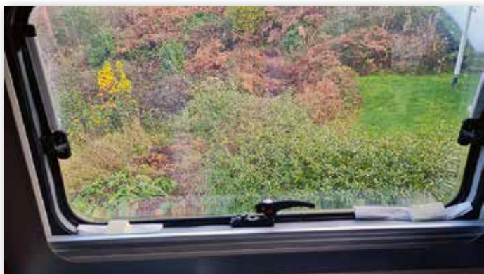
Prøvd tettet med fugemasse og ekstra list
