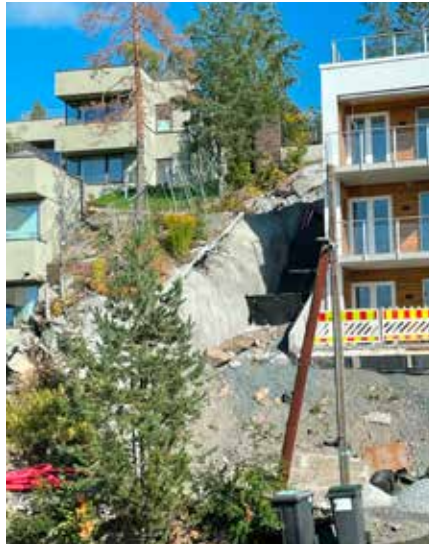
SKREKKEKSEMPEL: La oss slippe flere betong-sprøytede koller, Nils Collett Vogts vei 18 og 20.
