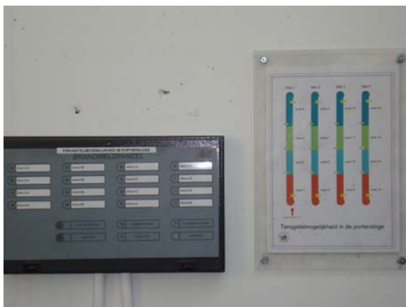
Sentralen for aspirasjonsanlegget med oversikt over de forskjellige sløyfene i parkeringskjelleren.
