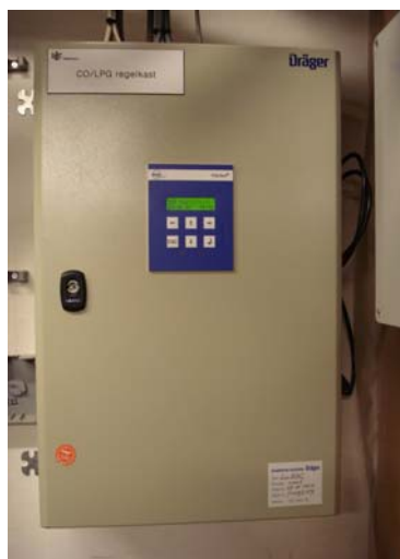
Sentralen for gassdeteksjons-systemet i parkeringskjelleren.
