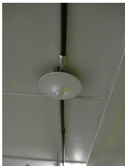
Antenneinstallasjon for brannvesenets radiosamband
