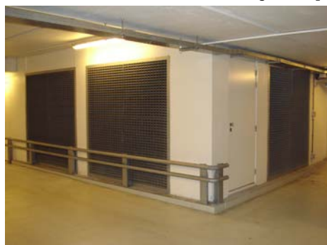
Avtrekkspunkter med brannspjeld (Rotterdam)
