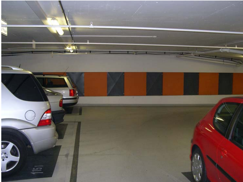
Tilluftsåpninger i den ene enden av parkeringskjeller (Frankfurt)
