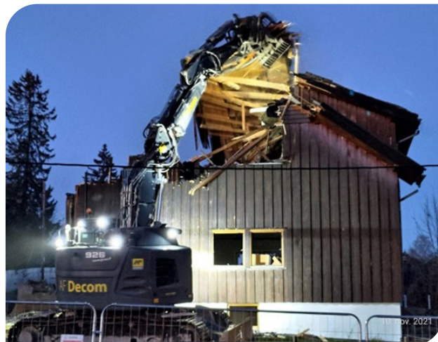
Rivingen av eneboliger i Kleivveien Nord foregikk i fjor høst, etter mørkets frembrudd som seg hør og bør.
