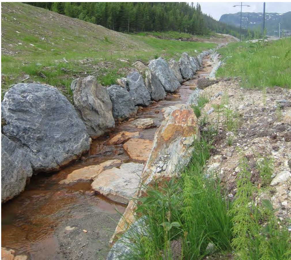
Figur 20: Bildet viser opparbeidet åpen løsning for overvannshåndtering langs hovedvegen Totteskogen.
