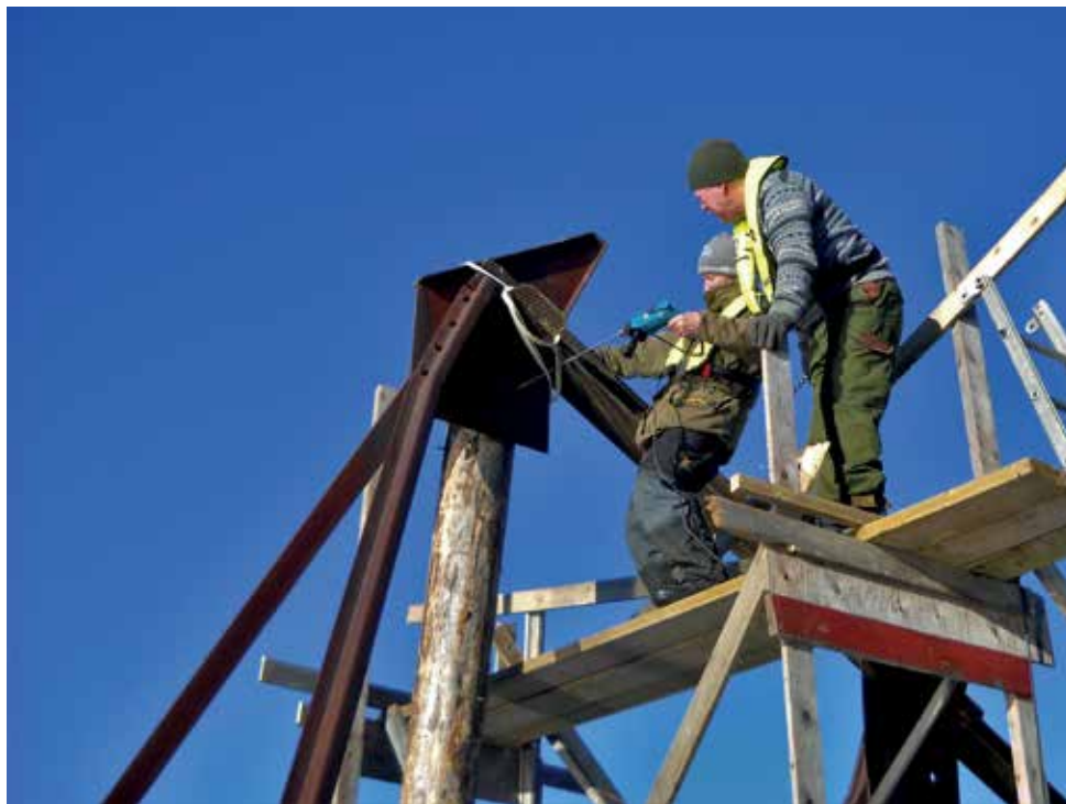
De største pålene holder hele karkonstruksjonen på plass. Morten Svendsen t.v. og Helge Hestvik i arbeid. Foto: Ole-Kr. Hammeren
