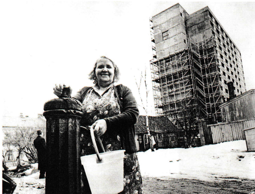
Flere av de gamle trehusene står fortsatt og vannpostene er i bruk mens den første høyblokken er under bygging.
