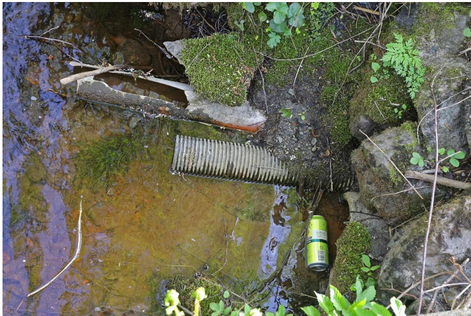
Figur 3. Eksempel på ulike rør som munner ut i elva (fra område 7)
