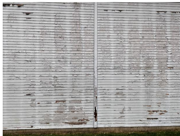
Dette er ikke et moderne kunstverk. Det er nordveggen på Berger Svømmehall. Den skriker etter maling, antakelig også ny kledning. (Foto: ES)
