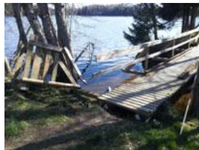
Ødelagt bro. Foto: DWS
