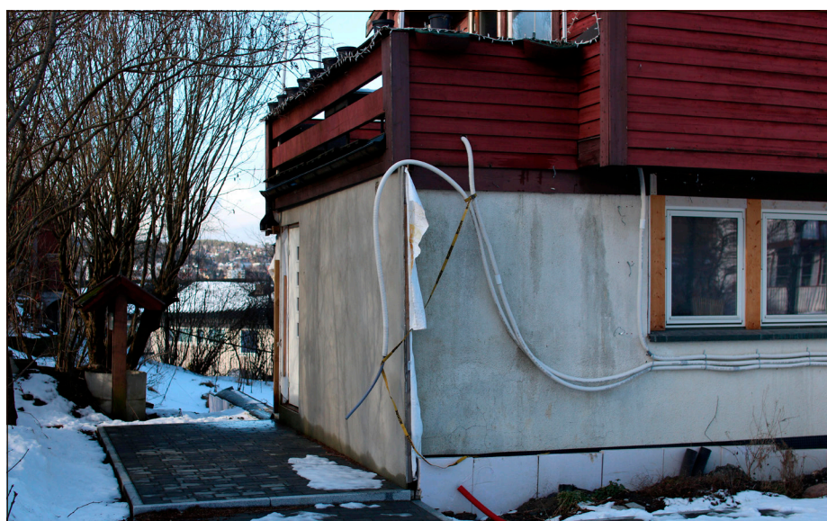
Ledninger som ikke er helt oppført etter boka.
