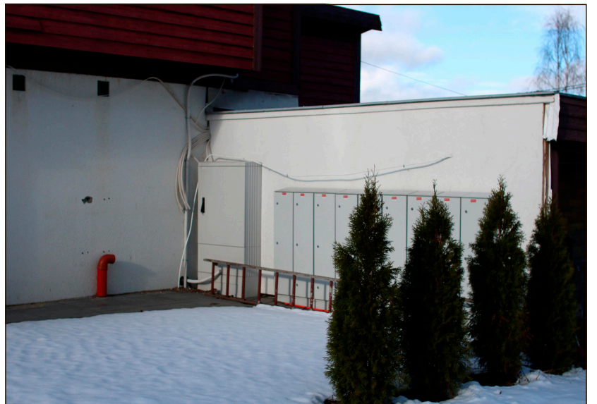
Litt uortodoks ledningsføring, og mange strømskap.
