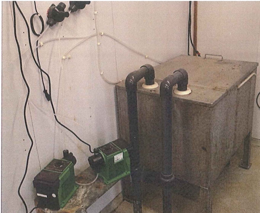
Figur 5 Pumpeledningene inn går til innløpskasse for å kontrollere mengden inn på kjemisk trinn. Opplegget med doseringspumper i forgrunnen virker provisorisk. Kjemikaliet er noe etsende, og sprut i øyne er skadelig. Pumpene burde vært montert i eget beskyttende skap. ( Med dør av klar plast)
