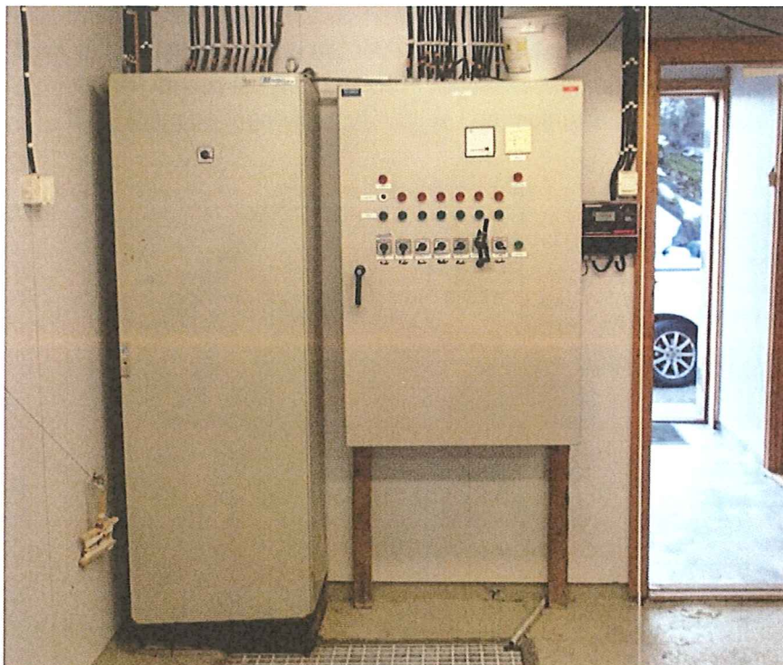
Figur 3 Skapen for inntak og styring av renseanlegget
