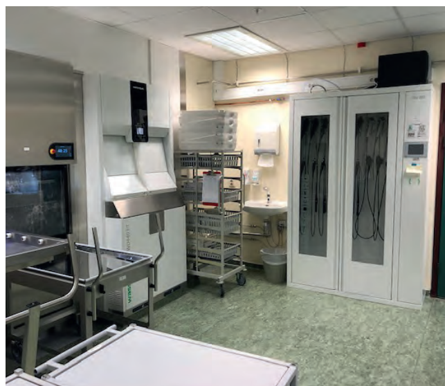
Gjennomgåede vaskemaskiner og varmeskap for fleksible scop.
