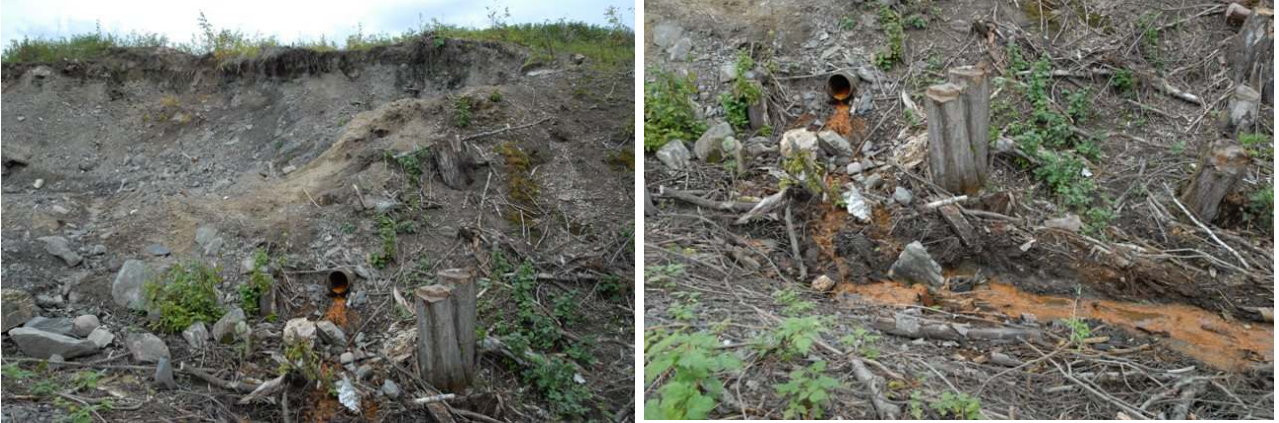
Eldre rør med forurenset vann fra massene på Økrisletta i Bråtesprekkbekken. Vegetasjonen i grøntbeltet og bekkefaret med til dels store trær er hugget. Masser er fjernet.
