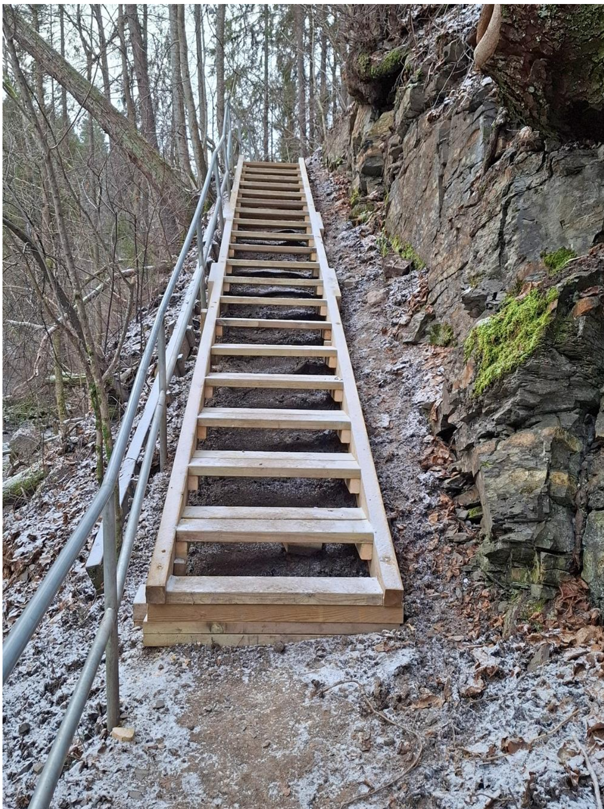
Ny trapp ved Sandbonn. Trappa mellom Sandbonn og gangbrua til Lysejordet ble byttet ut i høst og skrenten ved siden av ble renset for løse steiner. Denne er en av tre tretrapper langs turvei L-1 som byttes ut.
