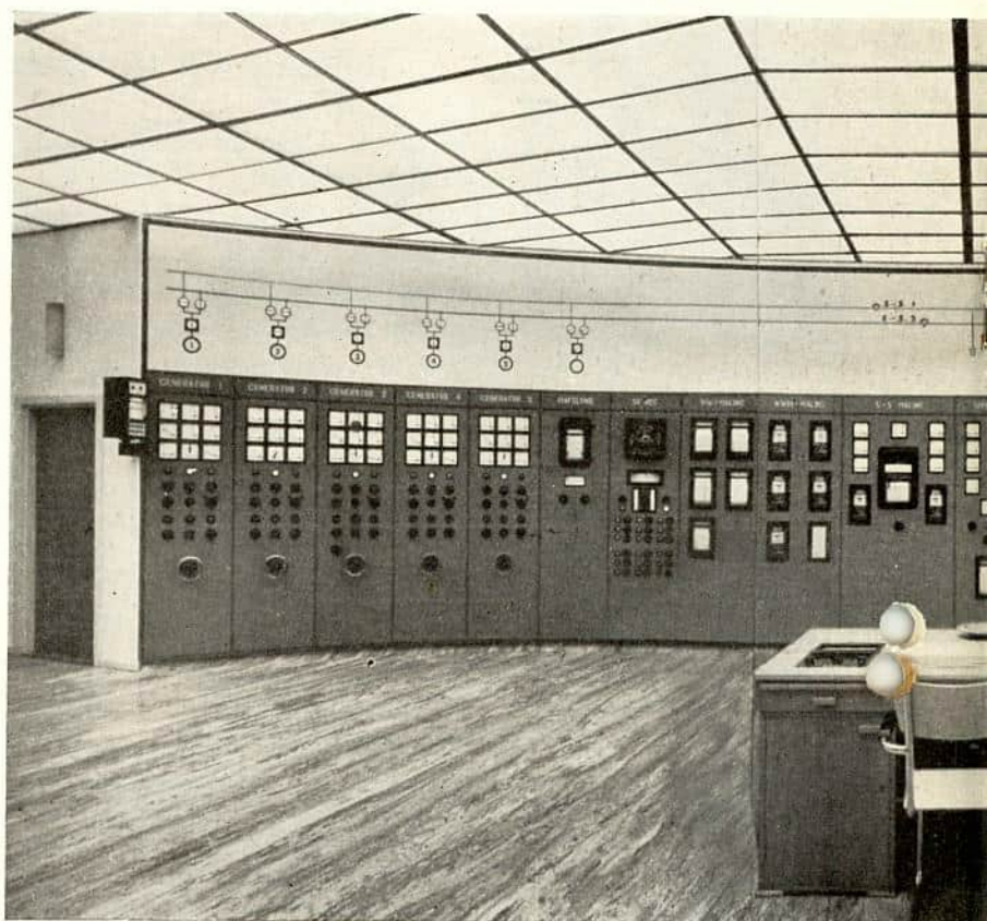
Det nye kontrollrom.
