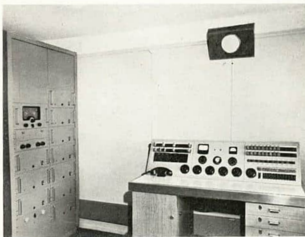
Forsterkerstativ og kontrollbord, Bislett.
