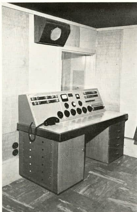
Kontrollbord med mikrofonforsterkerne på siden (Jordal Amfi).
