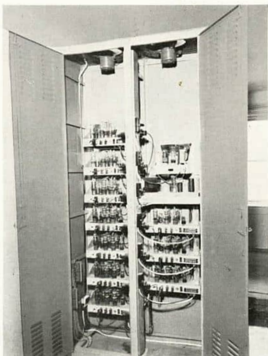
Interior av forsterkerskapet, Bislett.
