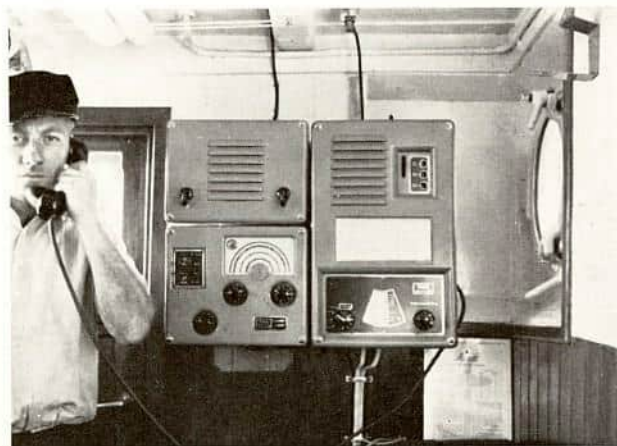
Kaptein A. Engen prøver det nyinstallerte radiotelefonianlegg.
