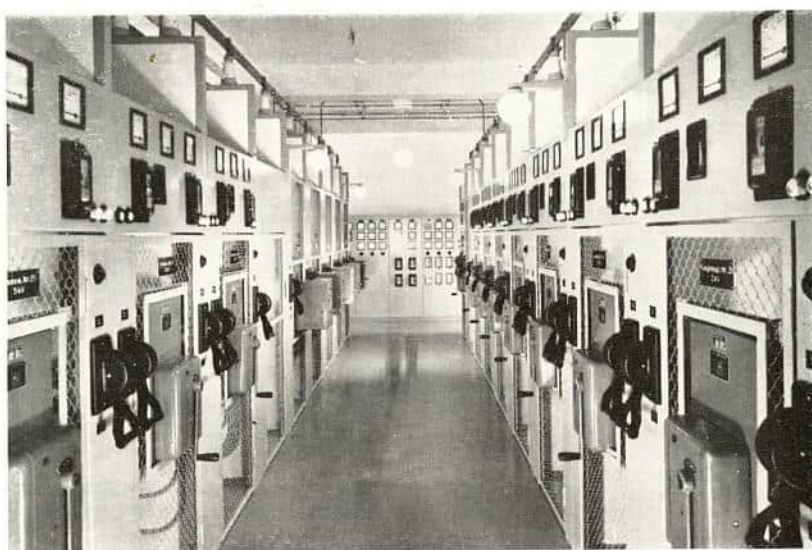
6 kV apparatanlegg i Bodo Sekundærstasjon.
