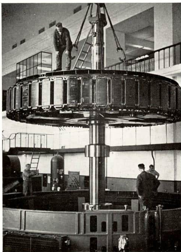
Generator 10, Solbergfoss. Det store øyeblikk da rotoren senkes på plass.
