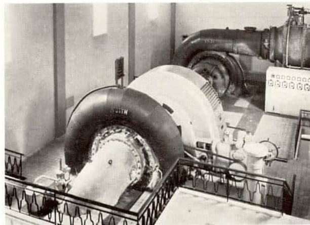
Generatoren er plassert mellom turbin (nærmest) og pumpe. Pumpeventilen sees helt til høyre på bildet. I styreskapet til høyre finnes styreventilene for pumpeventil, trottlev ventil, oljeventil, kjølevannsv ventil, trykkluftsv ventil osv.
