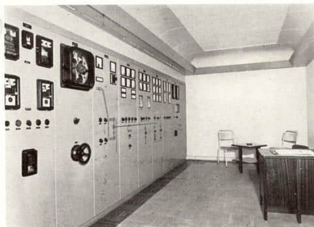
På grunn av at apparatanlegget er meget beskjedent er hverken kontrollrom eller apparattavle av de største. Generatoren er over en 15 MVA transformator og 8 km 60 kV-linje koplet direkte inn på samleskinnene i Follafooss.
