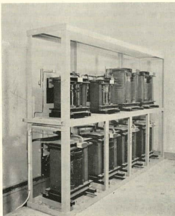
Fig. 10. Transformatorstativ med tilpasningstransformatorer.
