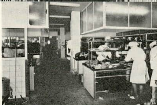
Glimt fra kjøkkenregionen som er et av de mest moderne i Europa. Elektriske installasjoner: Ca. 400 kW.
