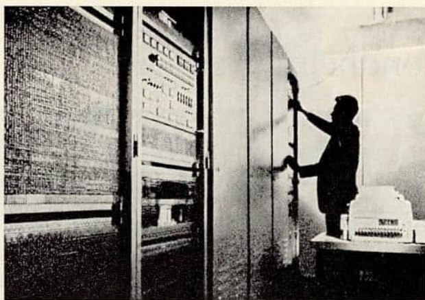
Siemens trafikkregner VSR 16000 montert i Erach.
