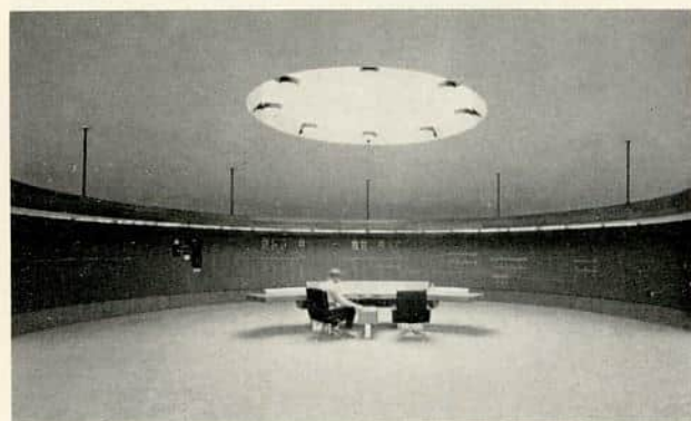
Kontrolltavle (portalbygg — Nesflaten).
