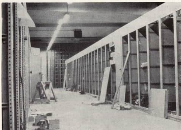
Vi ser en del av den lavspente hovedfordeling (G403-skap). Bildet er, som man ser, tatt under montasjeperioden.
