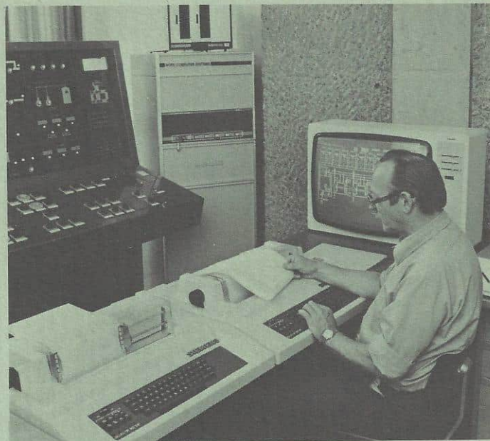
Kontrollrommet på Blindern - Lohre-Hansen fra driftsavdelingen ved betjeningsskrivener. I bakgrunnen den "gamle" tavlen (installert for 5 år siden) som bare dekket Biologibygget.
