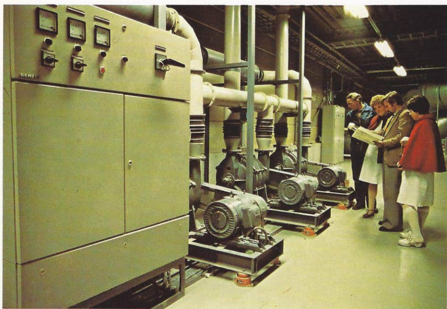
Imponerende dimensjoner på rørpostanlegget på Haukeland sykehus. Fra høyre sykepleierne Marit Sandvik og Sissel Larsen, videre ingeniør Harald Sappola og montør Knut Spord.
