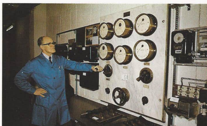
Bjarne Schrøen med god gammel Siemens apparat-tavle, montert i kulverten på Sluppen.
