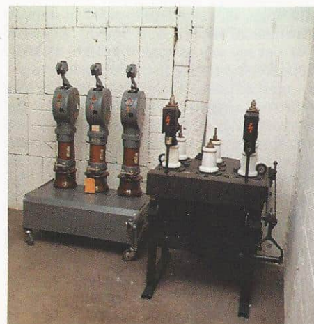
Brytere og transformator.
