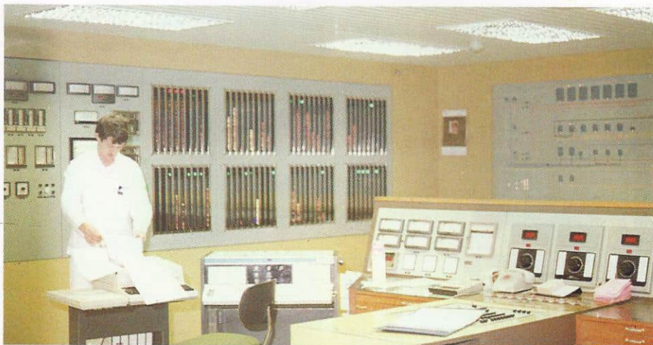
Ingen store forandringer i kontrollrommet på Fellesmeieriet siden det ble satt i drift for 10 år siden, kunne vi konstatere da dette bildet ble tatt for et par uker siden.
