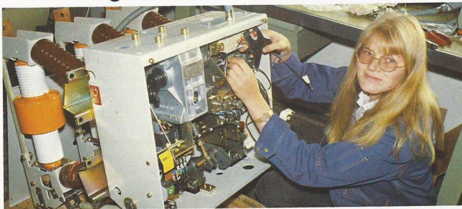
Elvi Husby monterer en høyspentcelle.
