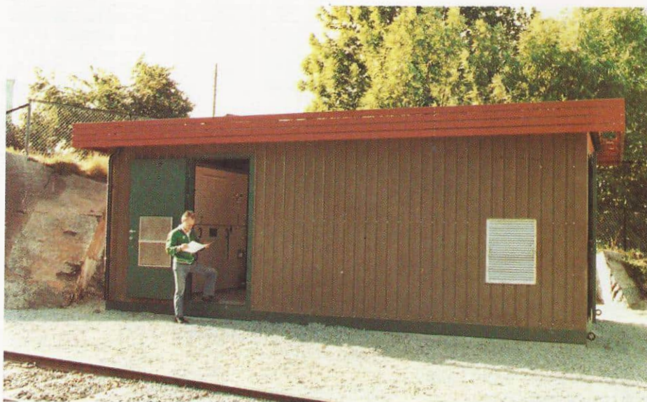
Den nye likeretterstasjonen fra Siemens ligger på Hauger holdeplass, og vil sikre en bedre trafikkavvikling på Kolsåsbanen.
