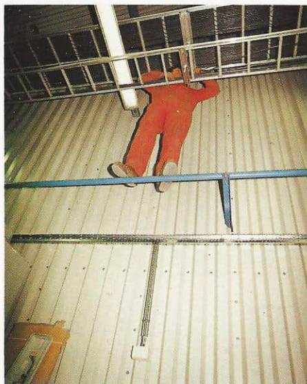
Hårreisende arbeidssituasjon fra Tyssedal, men heldigvis ingen Siemens-montør. (Foto: Ø. Larsen)
