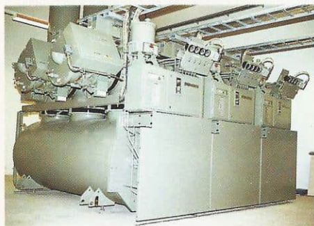
Kompakt, vedlikeholdsfritt materiell preger innredningen av stasjonen.
