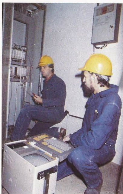
PLS-ingeniørene Torbjørn Voldsund (t.v.) og Ove Lillevik sjekker her de enkelte SIMATIC-moduler i en av de 12 understasjonene. Ingen problemer forbundet med å jobbe 140 m under havet, kan de to fortelle.
