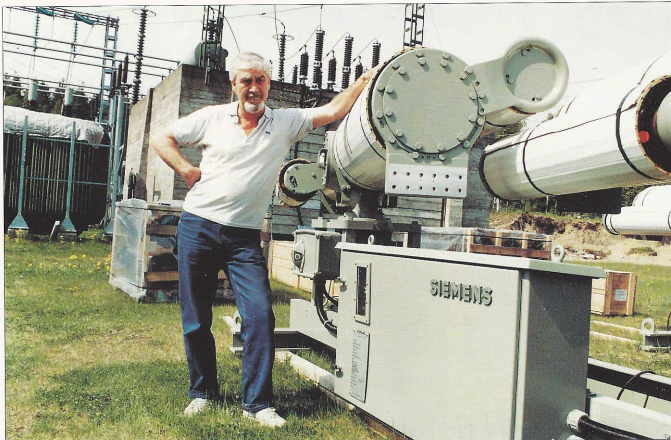
Svenn Danielsen har for tiden sin faste arbeidsplass på Minne Trafostasjon ved Minnesund
