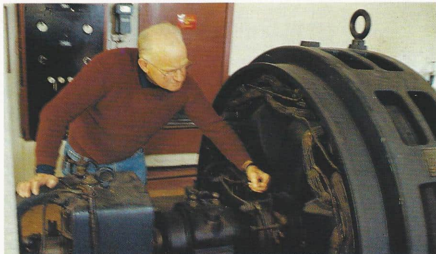
Maskinsjef G. Mejlænder demonstrerer innkobling av bronsebørstene på generatoren. De er kjent for å være særdeles fri for gnistdannelse.
