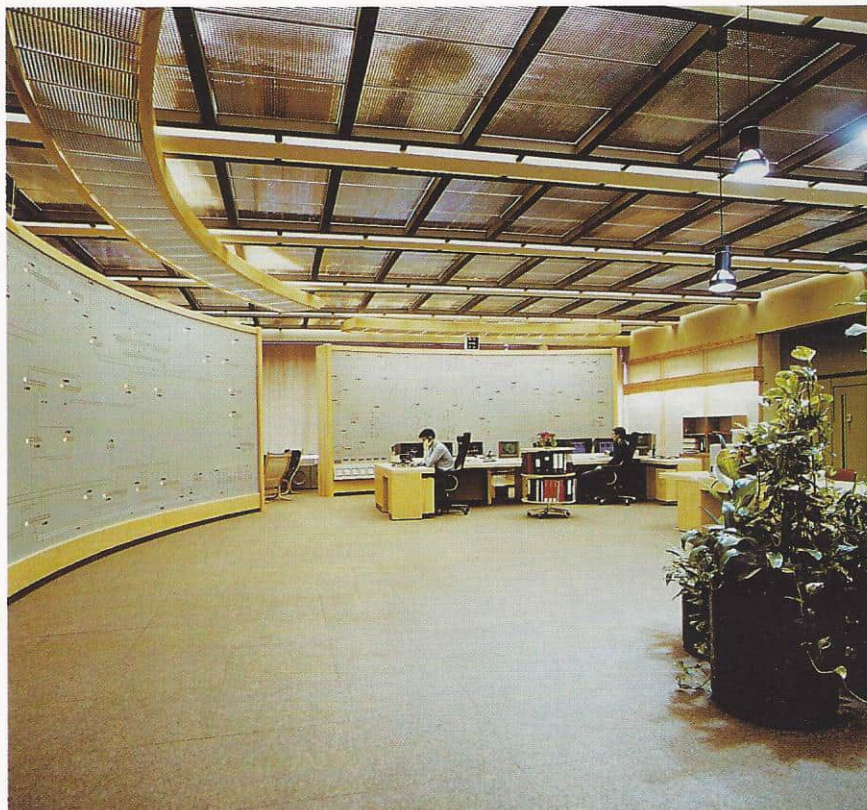
Fra Oslo Lysverkens overvåkningssentral på Smestad i Oslo. Foto: Siemens A/S.
