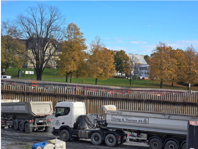
Bilde 4: Tungtransporter fra Diakonhjemmet hage på Volvat står i kø, i påvente av pålastning av masser til Vimas AS på Fornebu. Dokumentasjonen understøtter observasjonene om ulovlig mottak av masser fra ikke-godkjente prosjekter.
